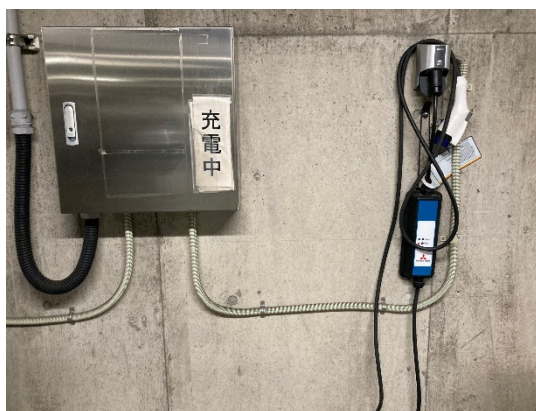
図3 EV 充電設備
