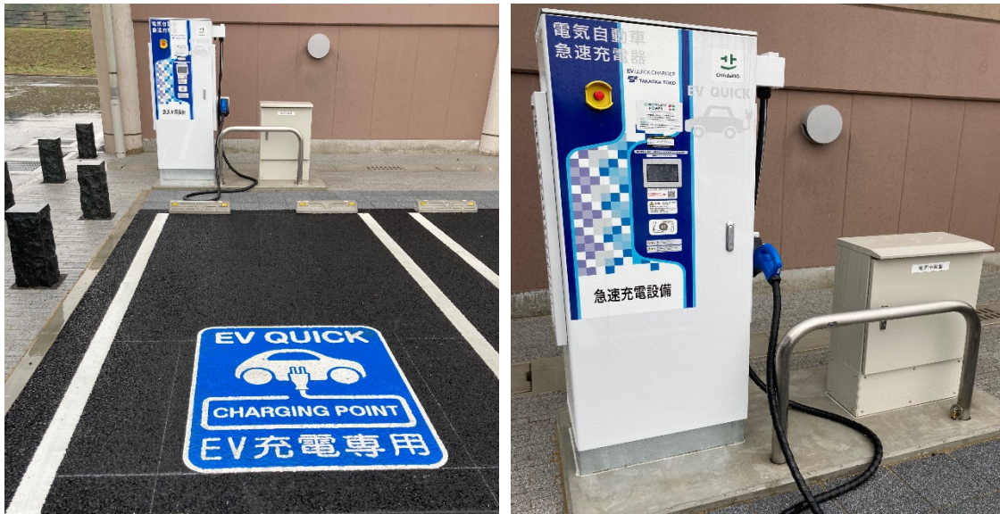
図1 宇佐市本庁舎 EV用急速充電設備利用用駐車スペース(左)およびEV用急速充電設備(右)
