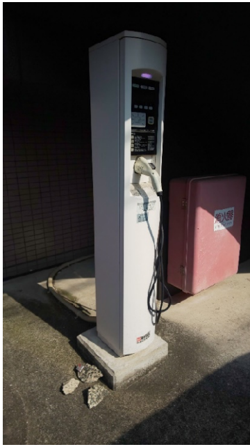
図 10 旅館に設置された低速充電施設（左）
