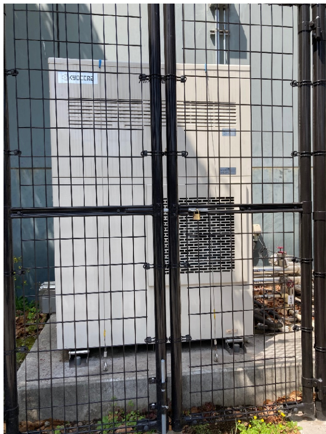
図4 大分市本庁舎に設置された業務用燃料電池
