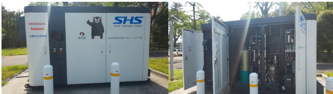
図8 熊本県庁内の水素ステーション
