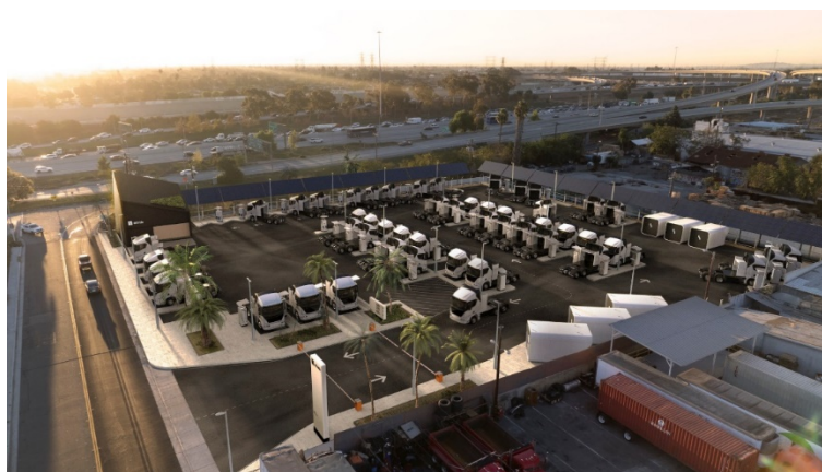
図 6. 2. 16 トラック用充電設備の例
