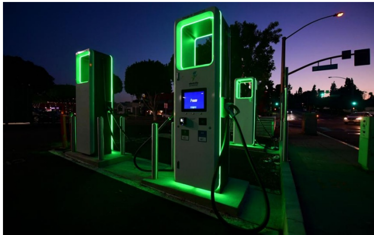
図 6.2.4 カリフォルニア州モントレーパークにある EV の充電ステーション
