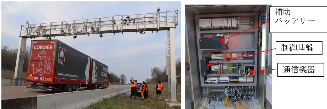
MLFF 課金ガントリー(試験用) と 制御装置内部
