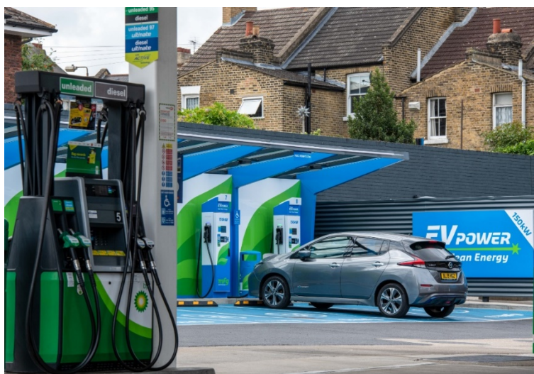
図 6. 2. 24 150KW の急速充電設備
