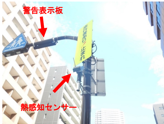
図 4.2 警告表示板と熱感知センサー（上り線側標識柱）
