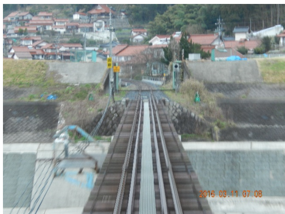
写真 2.10 因原付近の江の川支流の濁川堤防を裂いている陸閘門（2016. 3. 11、三江線に 7 か所設置された）
