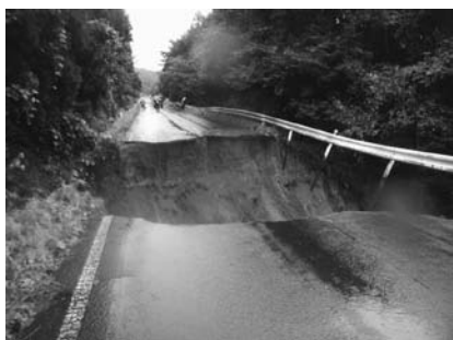
・3.11地震により沈下、クラック発生 地震災採択
